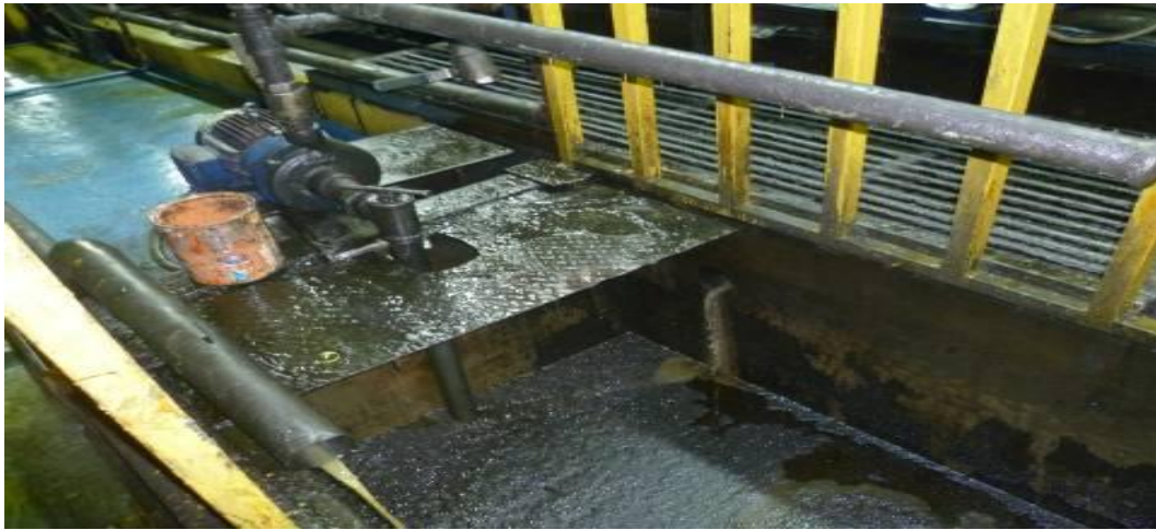
FIGURA 70. Tuberías deterioradas con fugas de refrigerante y usando tapones hechizos
