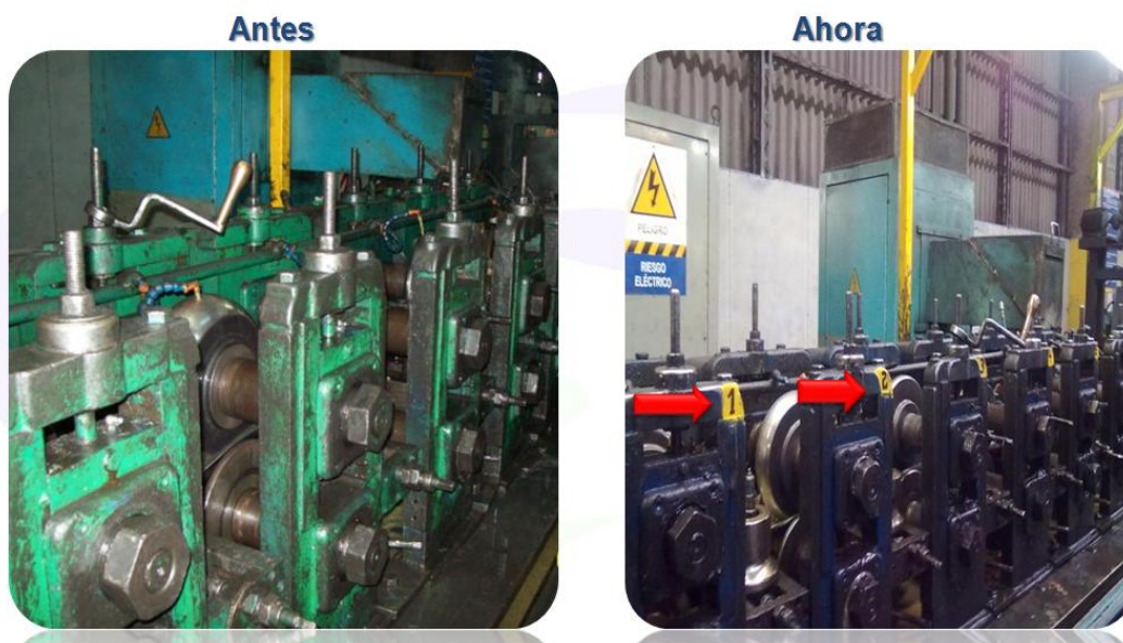
FIGURA 26.- Identificación de Postes de Rodillos Formadores.
