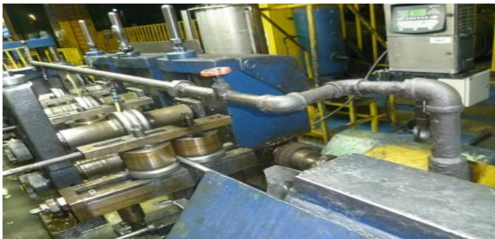
FIGURA 69.- Válvulas y Tuberías deterioradas en lugares no adecuados.
